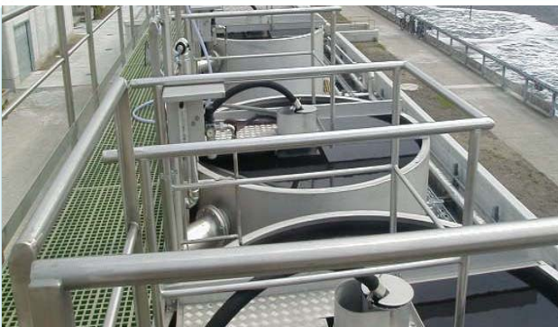
Reuse filtration plant
