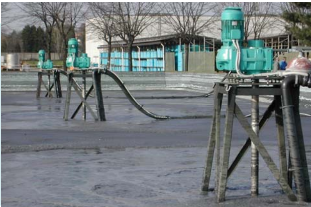
Vasca di ossidazione a fanghi attivi – installazione su cage
