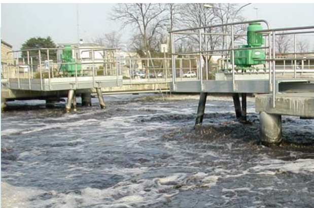
Vasca di ossidazione a fanghi attivi – installazione su passerella
