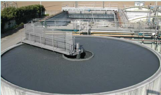
Flottazione Secondaria: Installazione in un'ispessitore dismesso.
