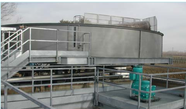
A-DAF con vasca in acciaio, installato sopra la vasca di ossidazione
